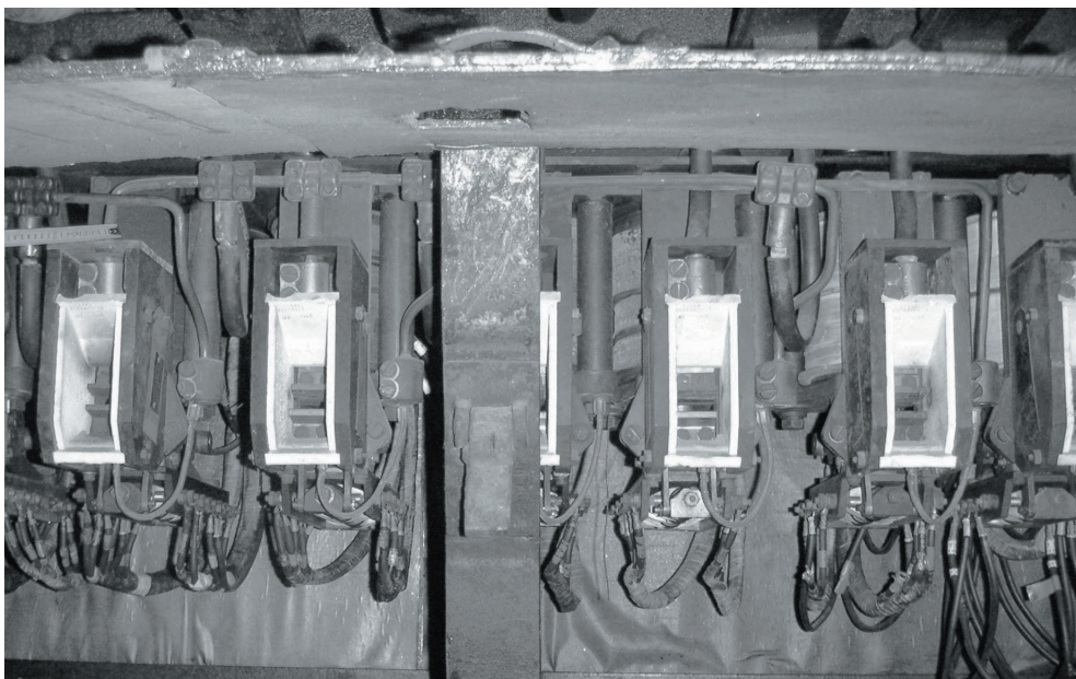
L'équipement électrique sous caisse de la motrice à 4 moteurs. Le caractère peu accessible de ces appareils a rendu les interventions malaisées jusqu'à présent. La mise en service des vérins de levage permettra d'y travailler confortablement. (photo Julian Pepinster)
