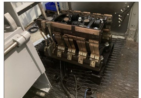
En haut, l'inverseur groupe 1 en cours de rénovation. (A. Marcinkiewicz et J. Pepinster) Ci-dessus, l'inverseur groupe 2 a été révisé et a repris sa place. (J. Pepinster)
