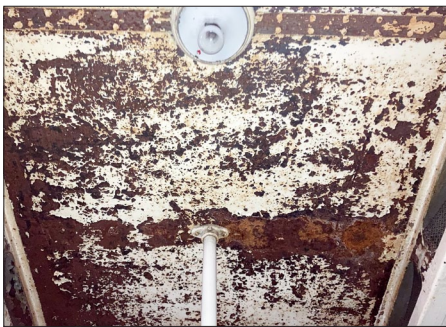
Ce n'est pas très joli à montrer, mais voici le plafond tel qu'il se présente actuellement. Au niveau des colonnes de plate-forme on distingue les points de fixation, tous corrodés. (J. Pepinster)
